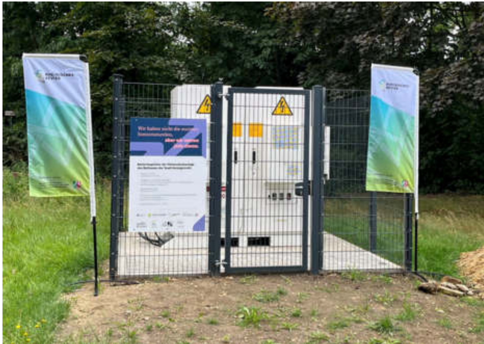
Abbildung 2: Batteriespeicher am Rathaus von Herzogenrath
