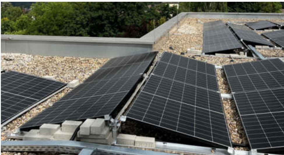
Abbildung 1: Dach-PV-Anlage mit Ost-West-Ausrichtung
